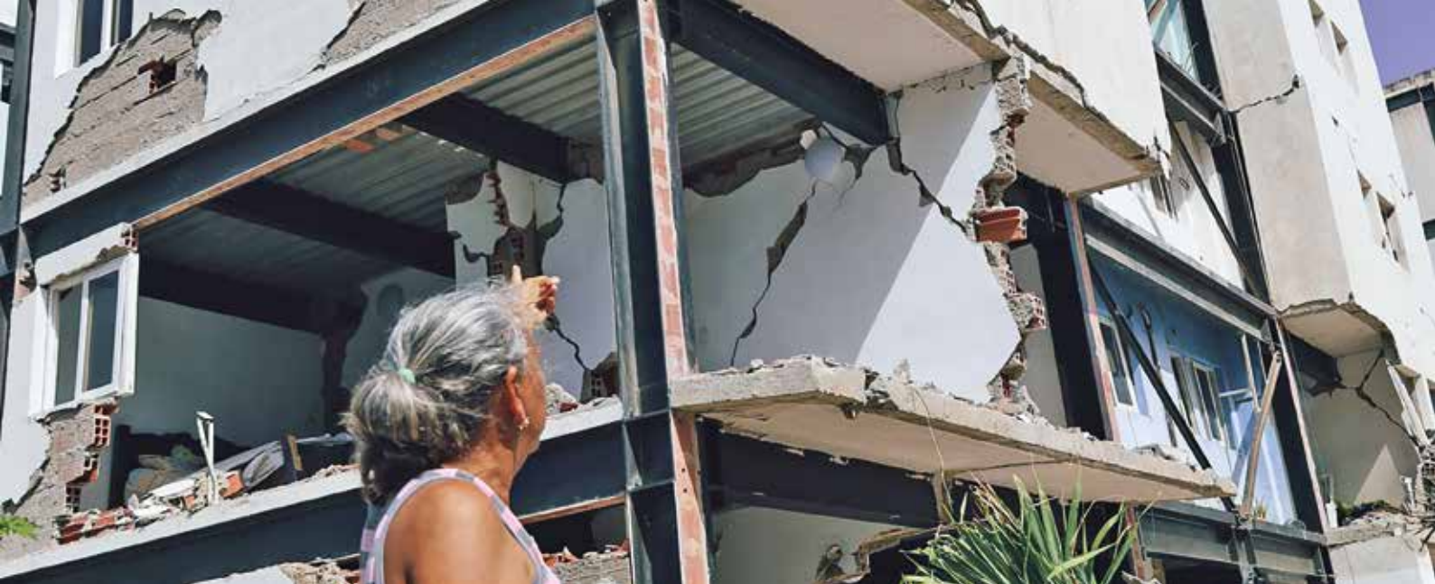
Oneida zeigt ihr altes Haus, aus dem sich die Familie retten konnte. Das Gebäude ist massiv einsturzgefährdet. Es wird nicht wieder ihr Zuhause sein können.
