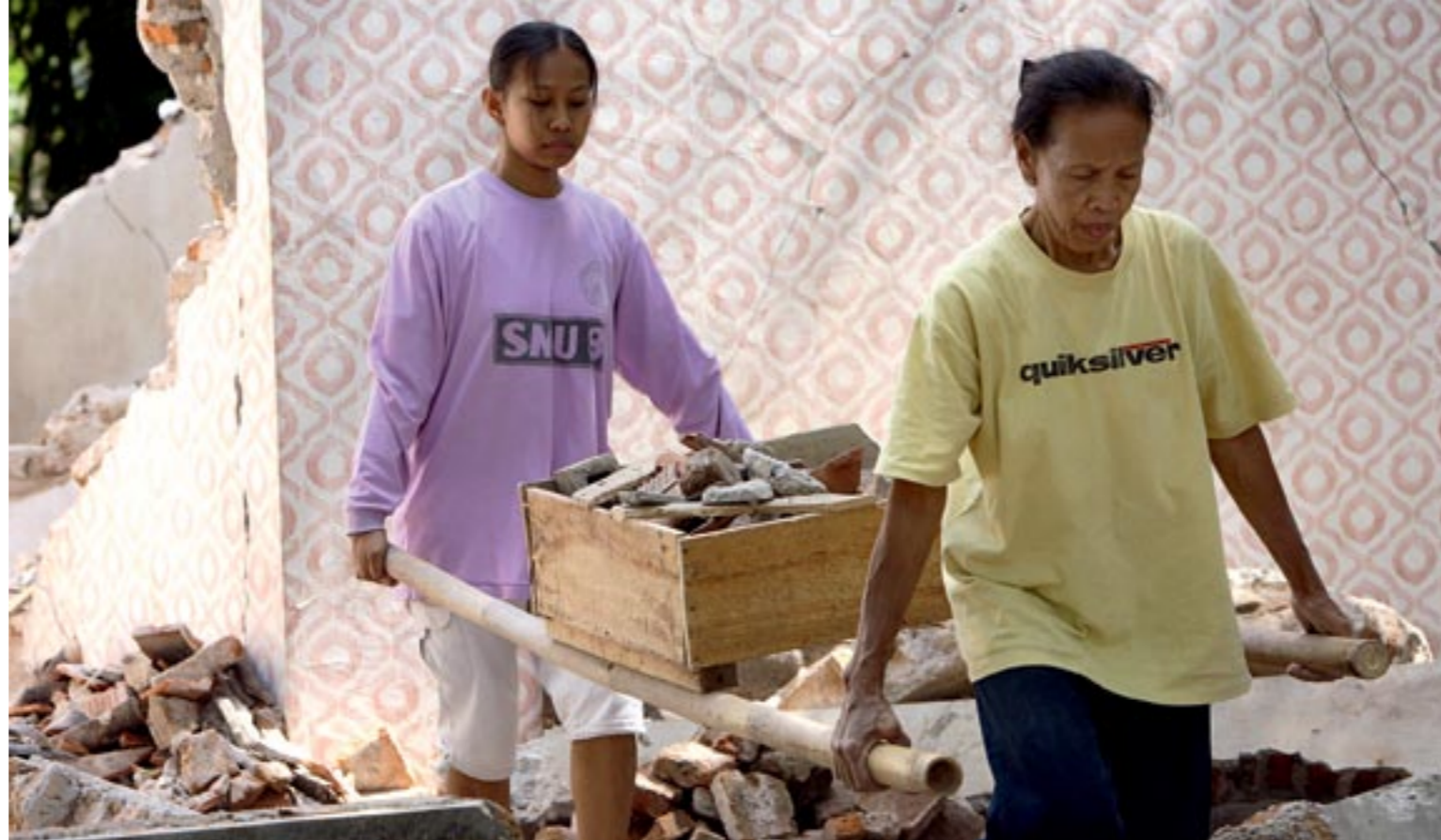
Familie und Nachbarn helfen sich gegenseitig bei Aufräumarbeiten.
